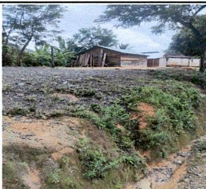
Foto 3: Instalaciones en mal estado
